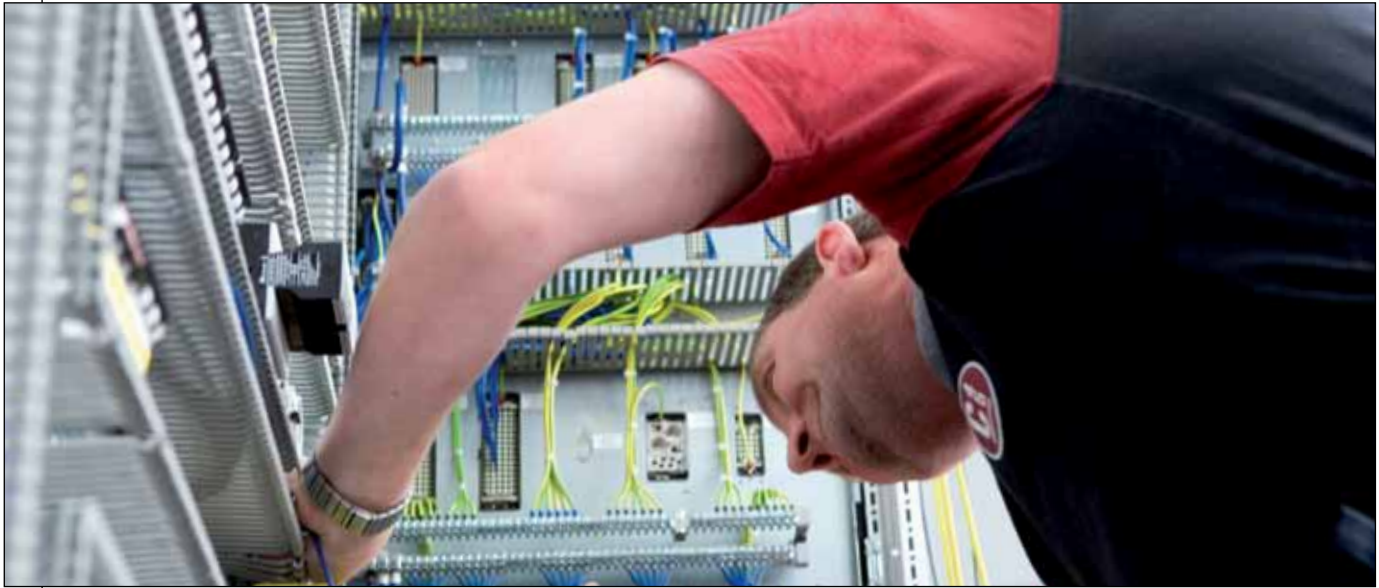
Auf Fehlersuche: An der Schulungsanlage können Störfälle in zahlreichen Varianten simuliert werden, die die Probanden beheben müssen.
